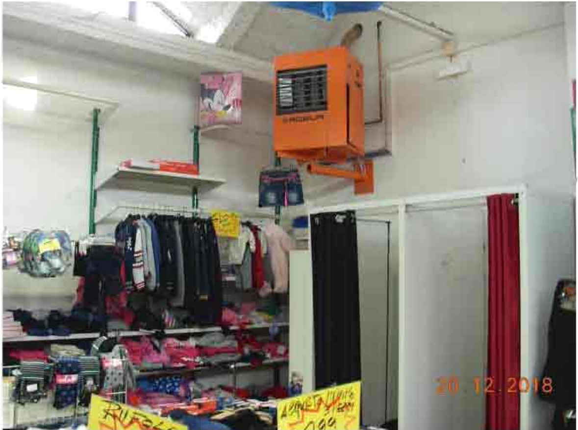
Termoconvettore (non funzionante)
